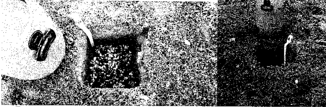
Fotos 01 e 02 – Trincheira pronta para início de saturação e aspecto de localização.
