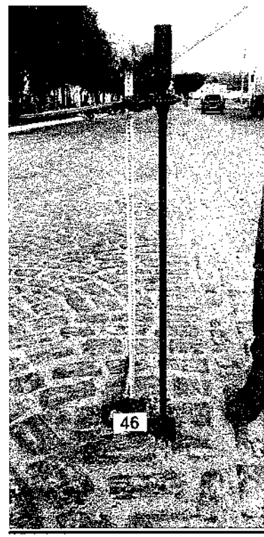
Foto 70 – ST 46 – Aterro sobre solo argiloso e rocha alterada. Av. Paulo Bastos c/ Rua Jorge Domingues, com revestimento em paralelepípedo.
